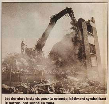
En bordure du port, le mur de la rotonde est à son tour livré au godet de la pelleuse.
